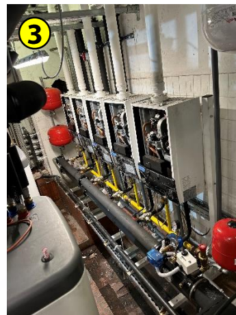
5x caldaie Daikin D2C
