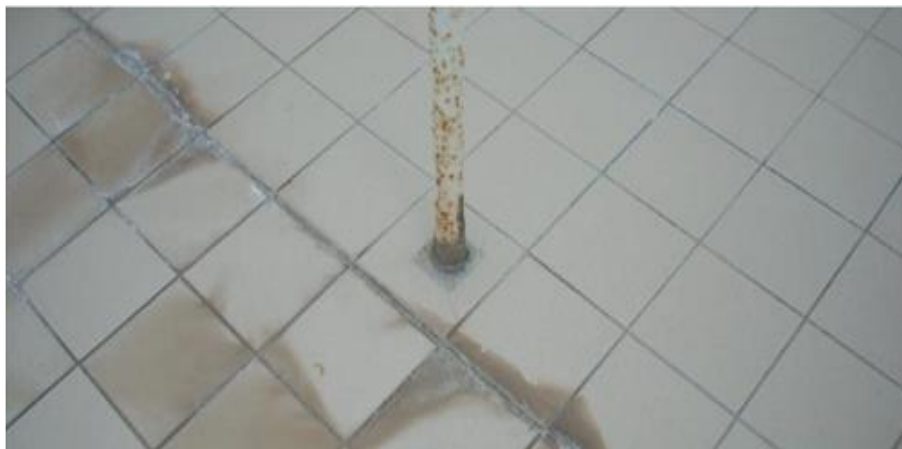
Efflorescenze sulle fughe
