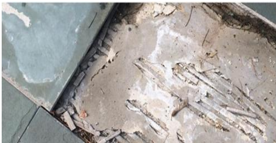
Distacco delle piastrelle
