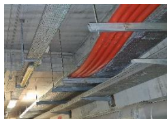
La rete di distribuzione in media tensione
