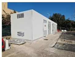
Le cabine di trasformazione MT/BT
