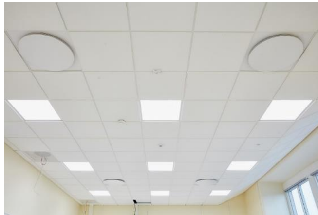
Sala controllo: CON condotti e diffusori
