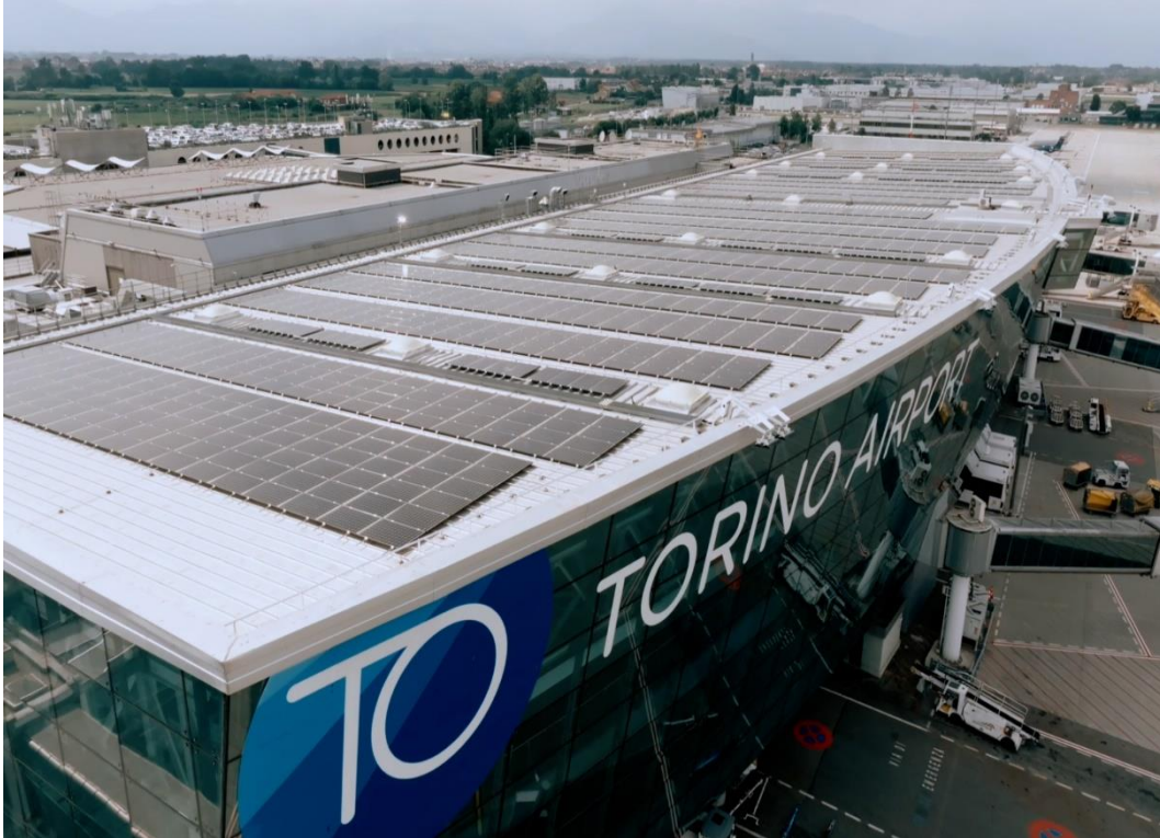
Impianto da 1,44MW – Luglio 2023 – Courtesy AllEnergy&Architecture
