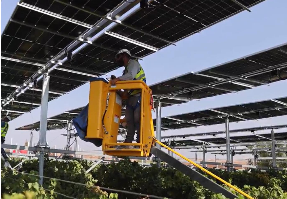
Impianto agrivoltaico – presenza di persone, animali e macchinari. Alto rischio di elettrocuzione, danneggiamento cavi, ecc
