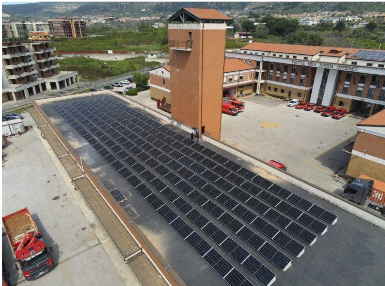
Impianto da 100kW – Courtesy Resit SRL
