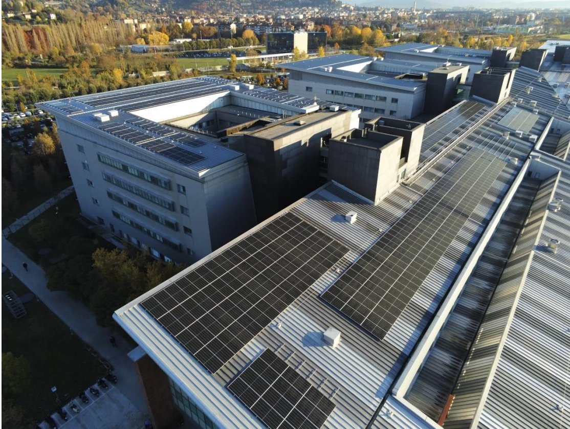
Impianto da 364kW– Aprile 2024 – Courtesy Resit SRL
