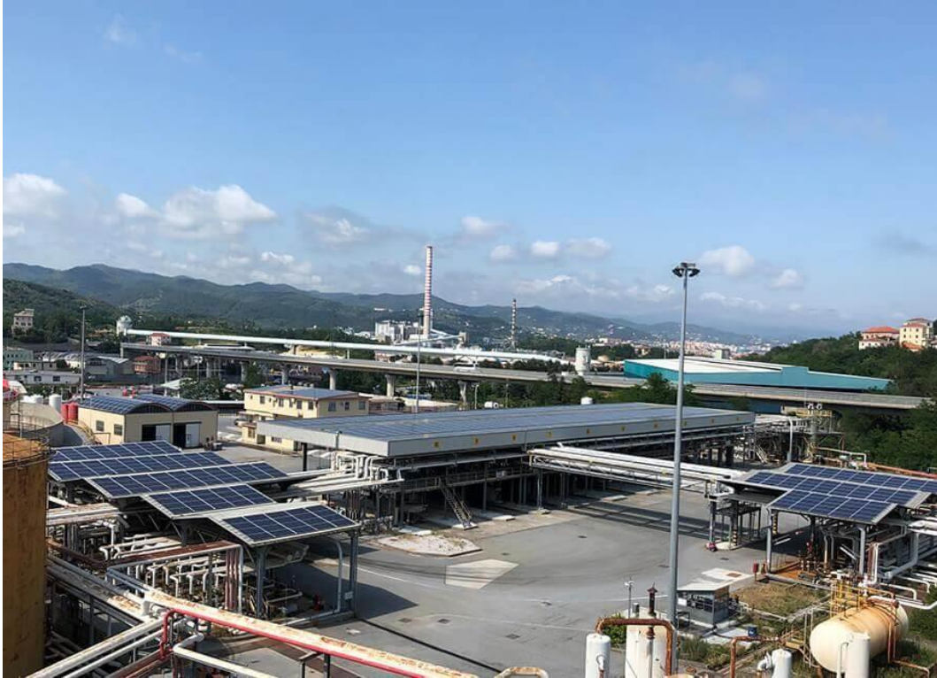
Impianto da 560kW – Luglio 2018 – Courtesy AllEnergy&Architecture
