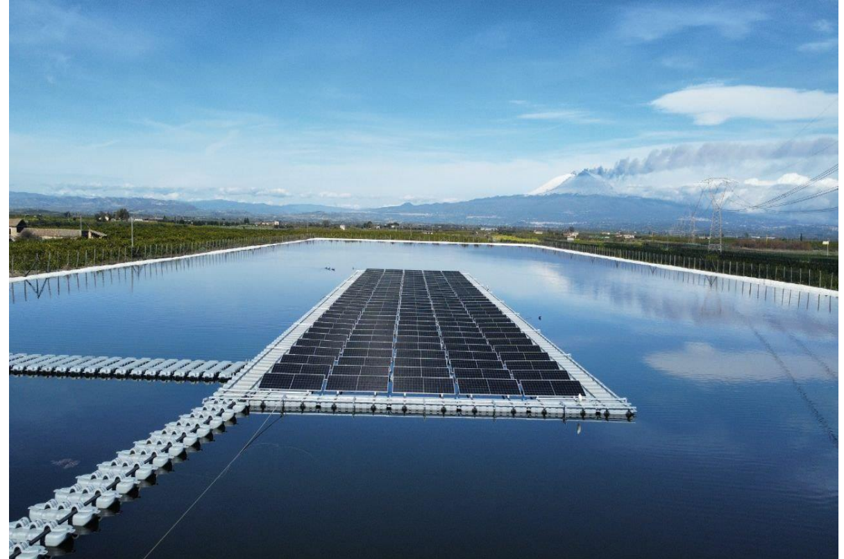
Impianto fotovoltaico flottante – acqua ed elettricità insieme
