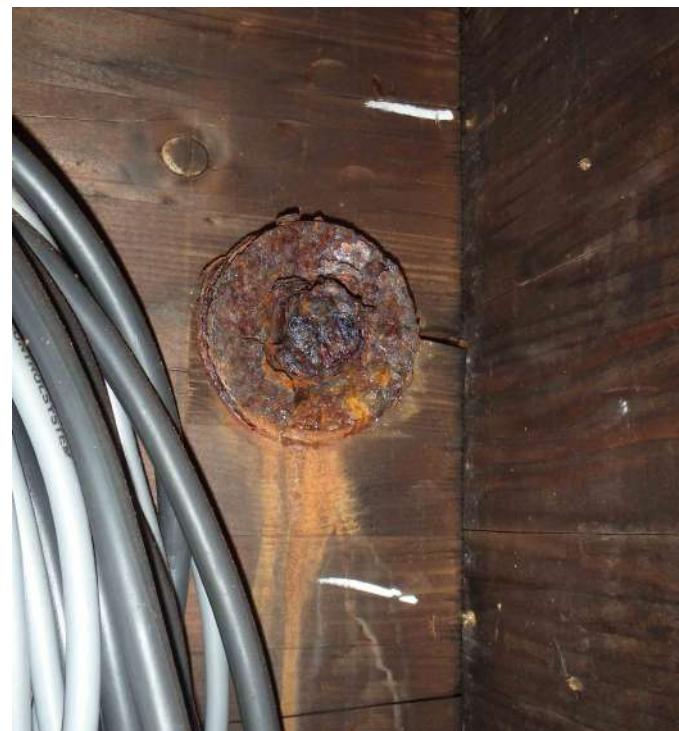
Degrado carpenteria metallica
