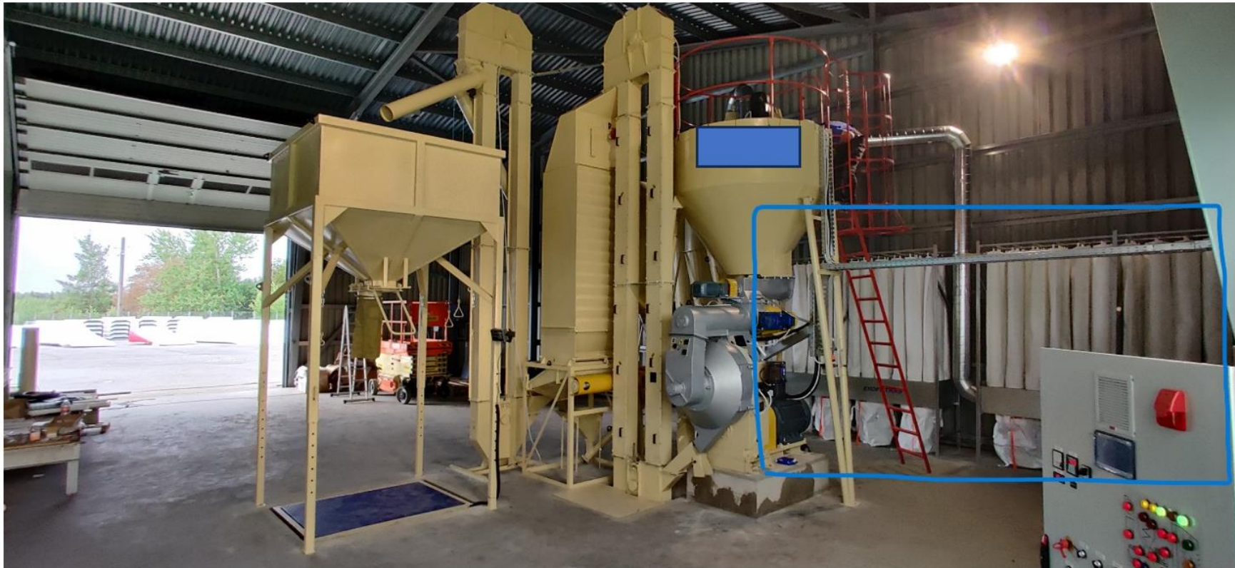
Figura 1 – Filtri a manica senza alcun carter di contenimento e vicino a quadro elettrico normale
