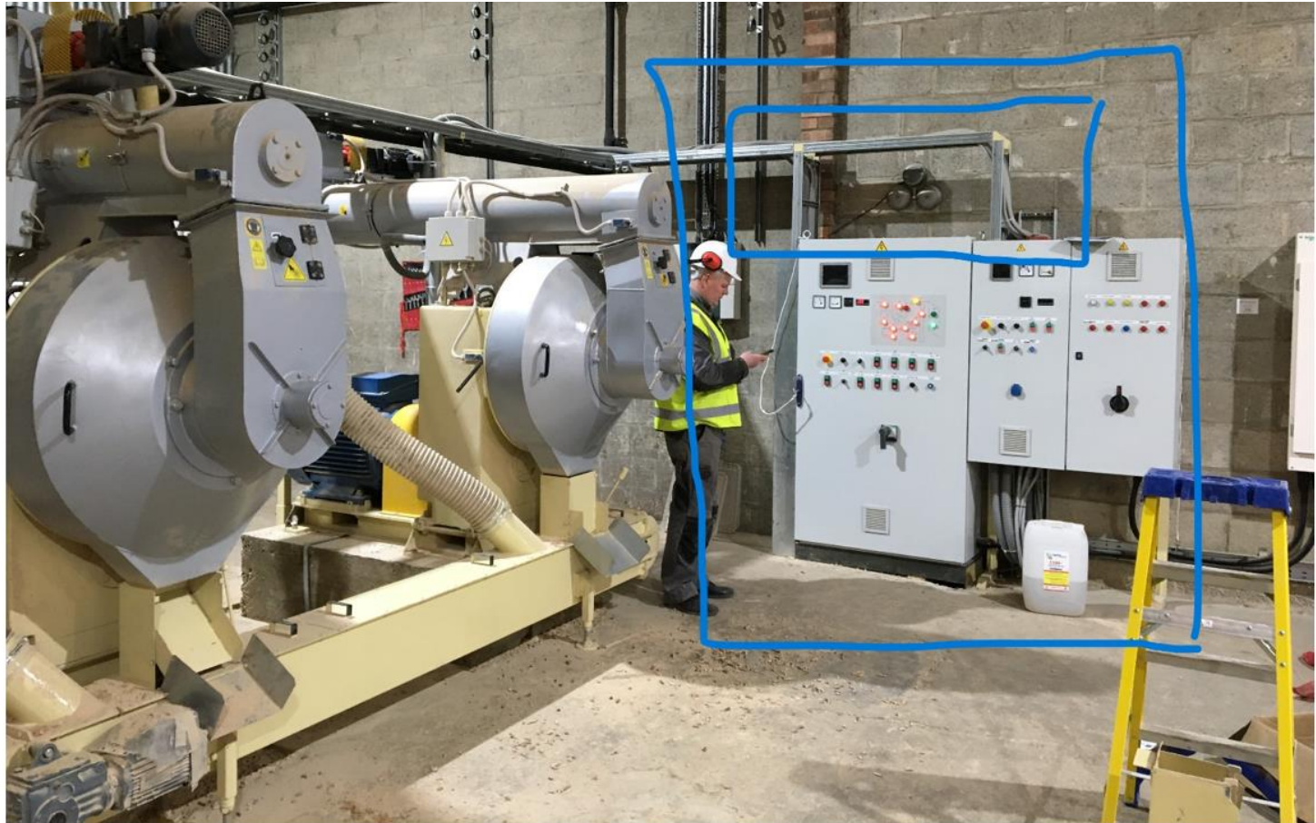
Figura 2 – Quadri elettrici normali con polvere sotto. I quadri, i pressacavi e le apparecchiature elettriche non sono adatte per l'area pericolosa, che sicuramente non è stata classificata.
