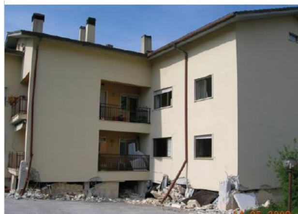
◀ Terremoto dell'Aquila del 2009: M=6,3
