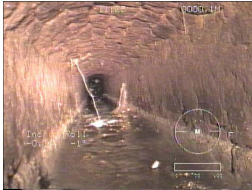
Foto: 1, Video: VHS 1, : : Inizio ispezione, Scavo di accesso identificato pozzo n° 2, dalla panoramica si nota la mancanza di intonaco dalle pareti
