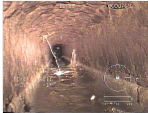
Foto: 1, Video: VHS 1, : : Inizio ispezione, Scavo di accesso identificato pozzo n° 2, dalla panoramica si nota la mancanza di intonaco dalle pareti
