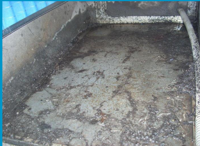
Es. Unità di trattamento aria sporca
