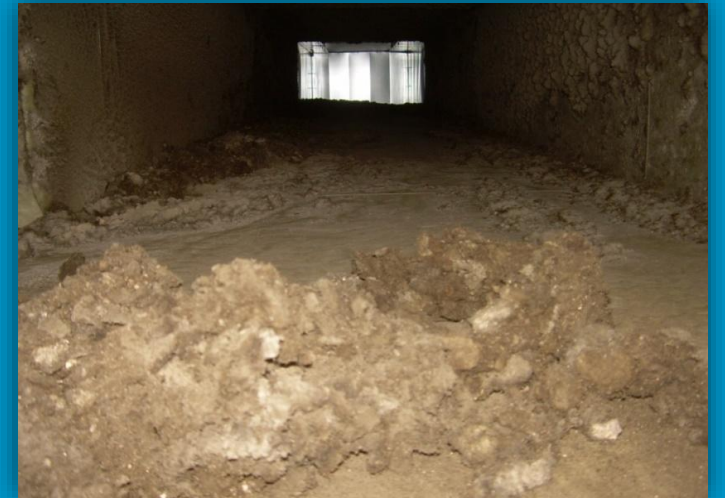
Es. Canale contaminato
