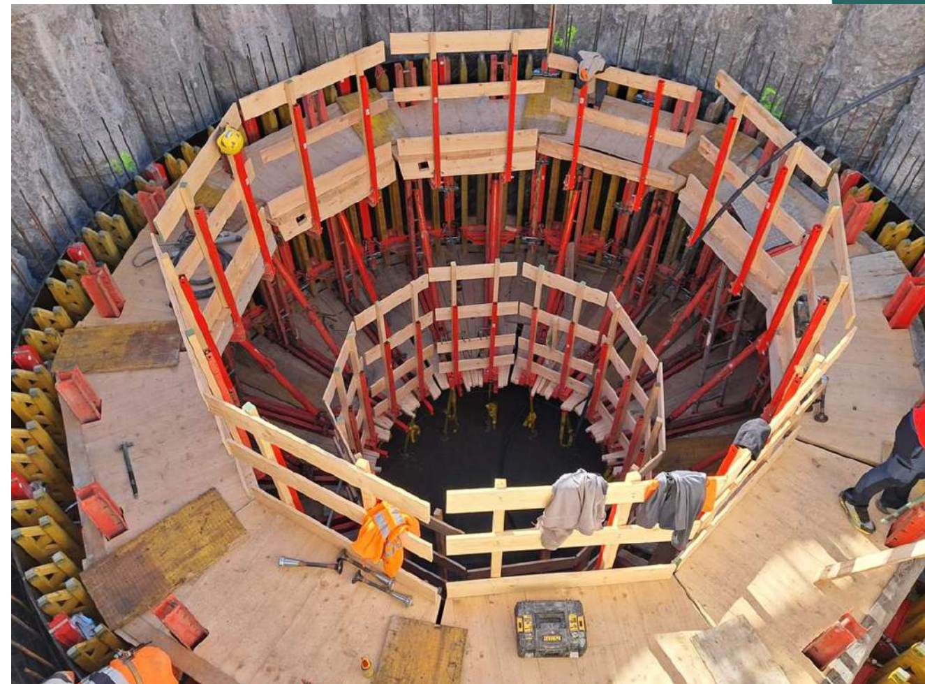
Foto in alto: particolare dell'armatura della centinatura Foto a fianco: cassature della centinatura
