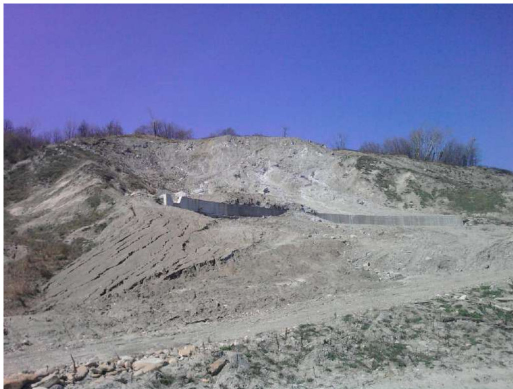
MOVIMENTI FRANOSI LOCALI CA' LITA - ANNO 2013 EVIDENZE DI DEFORMAZIONI NELLE OPERE POSTE SULLA SCARPATA A VALLE DELLA PIANA
